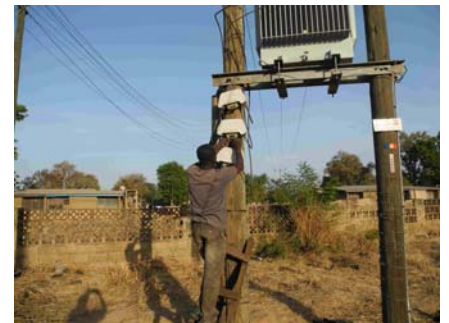
Sicherungen am Trafomast
